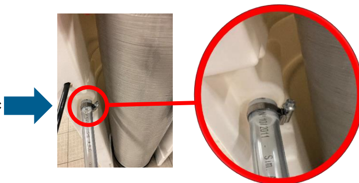
Raccordement trop-plein côté bac
