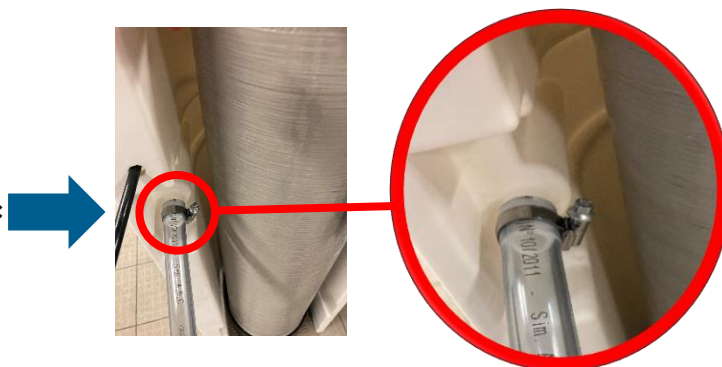
Raccordement trop-plein côté bac
